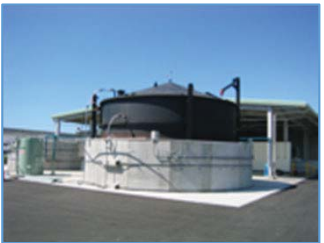
バイオガス発電
